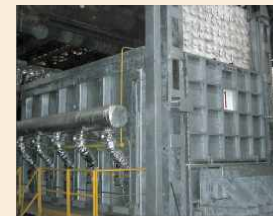
Печь после реконструкции
